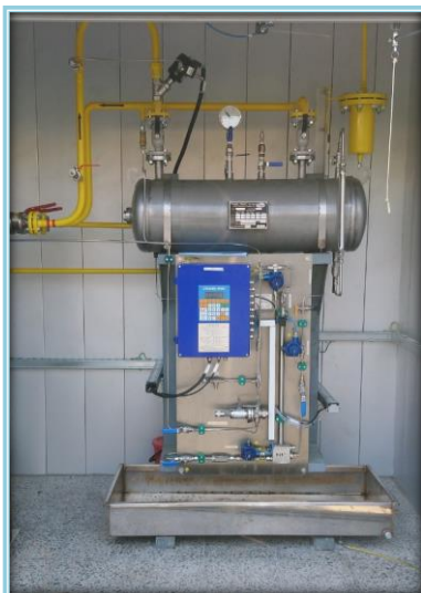
Instalovaná odorizační stanice OSGC-ST1 v kombinaci s kontaktním systémem -ilustrační foto-
