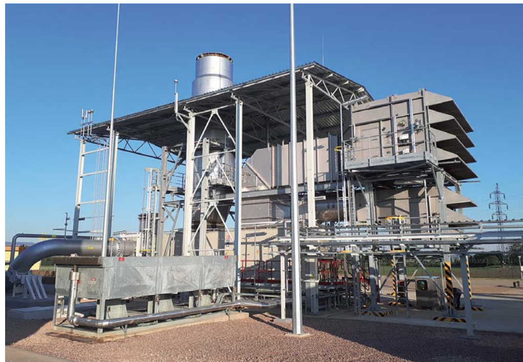
GASCONTROL instaloval turbosoustrojí v kompresorových stanicích Kouřim a Břeclav
